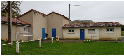
△ Les vestiaires sont vétustes et placés en zone inondable.
