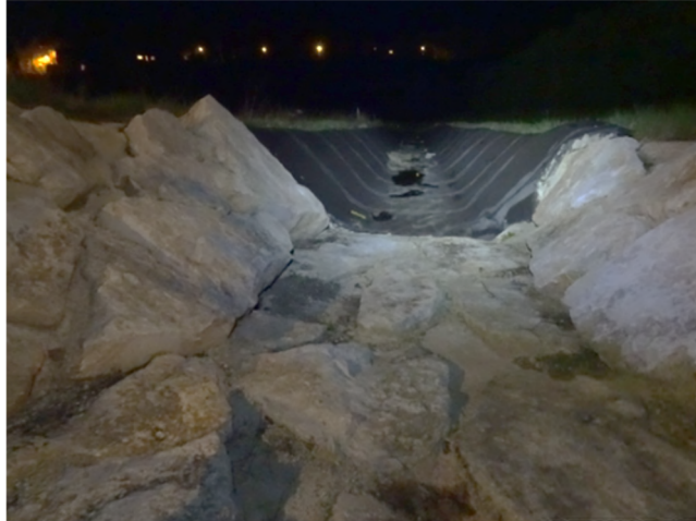
Ci-dessus, vue sur la tranchée drainante – point d'inventaire N°5.
