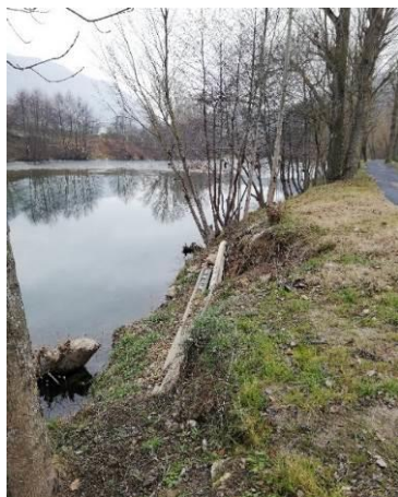
Berge érodée avant travaux
