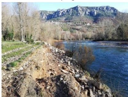
Berge d'un camping érodée par la crue de juin 2020
