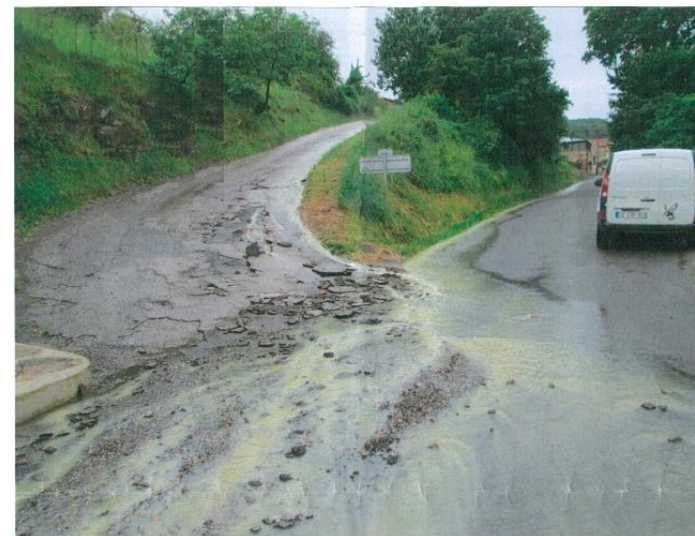
Erosion de la route d'accès, quartier de Salabuau, Rivière sur Tarn (étude PAPI d'intention)
